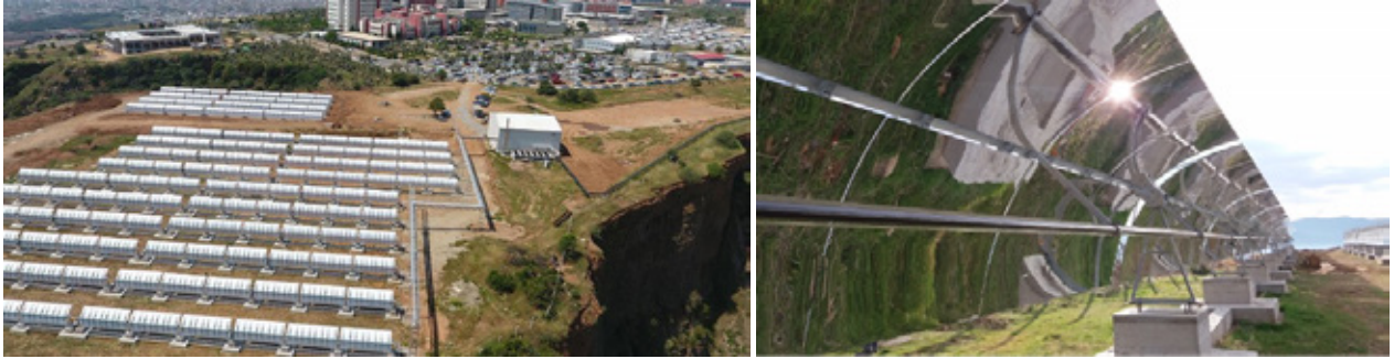
Şekil 22: Aydın Adnan Menderes Üniversitesi kampüsü içerisinde yer alan yoğunlaştırılmış güneş enerjisi sistemi [18]
